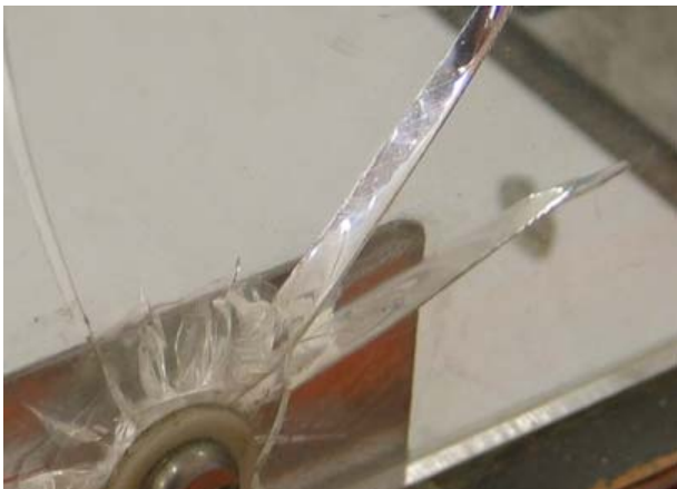
Abb. 09: Eine durchsichtige Glasscheibe wird beleuchtet. Dort, wo Risse sind, tritt das Licht aus und wird sichtbar. /Balck: triftstrasse.htm/
